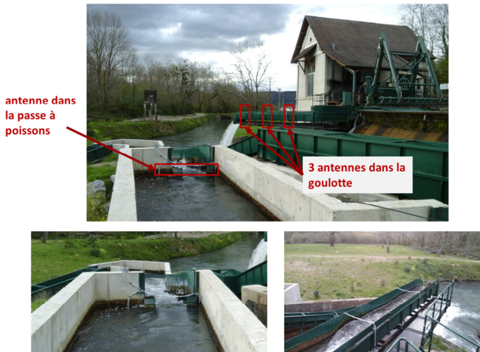
Figure 20 : Photos de la centrale hydroélectrique de Gotein avec l'emplacement des antennes RFID.
